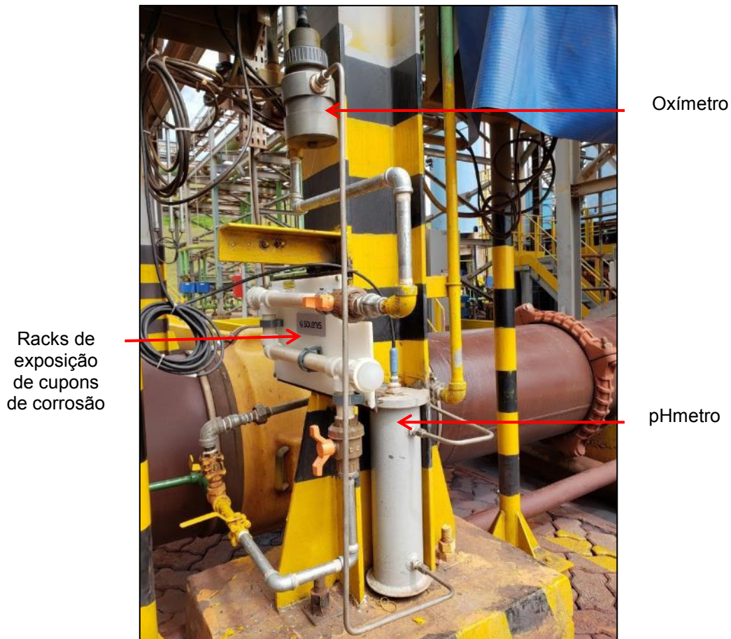
Figura 3.1.7 – Rack de exposição de corpos de prova à água de processo.
