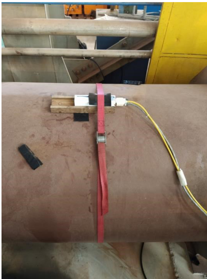
Figura 3.2.6 - Sensor magnético triaxial posicionado no duto de descarga da EB1.
