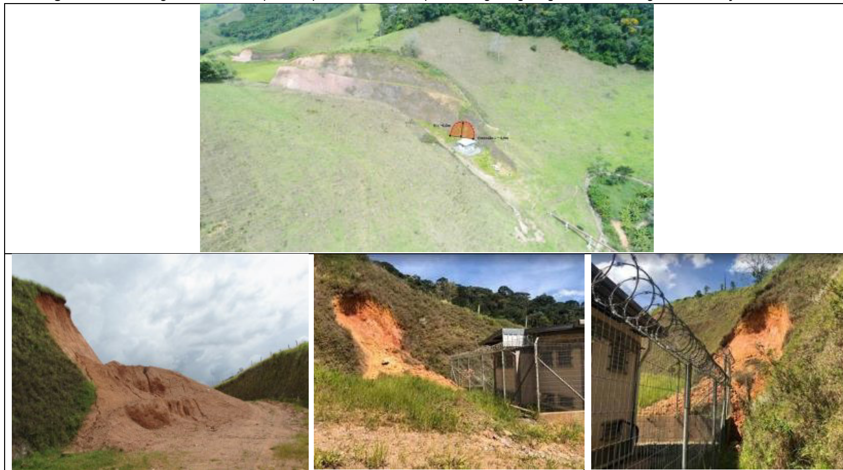
Figura 3.3.3 – Fotografias enviadas pela empresa ilustrando o processo geológico-geotécnico deflagrado em função da chuva.
