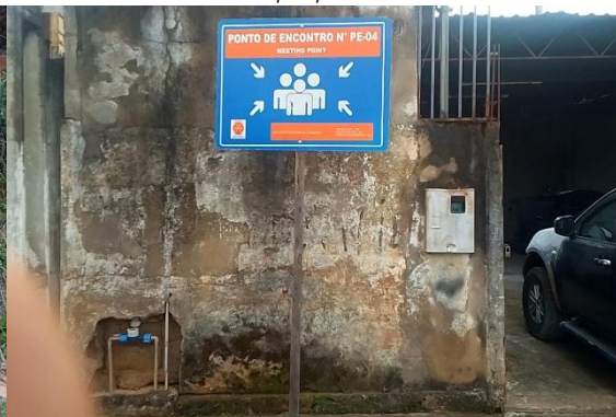
Visita de campo – Placa sinalizadora do Ponto de Encontro 04 . Estação de Bombeamento 2 (EB2), Anglo American. Santo Antônio do Grama (MG), 19/05/2026
