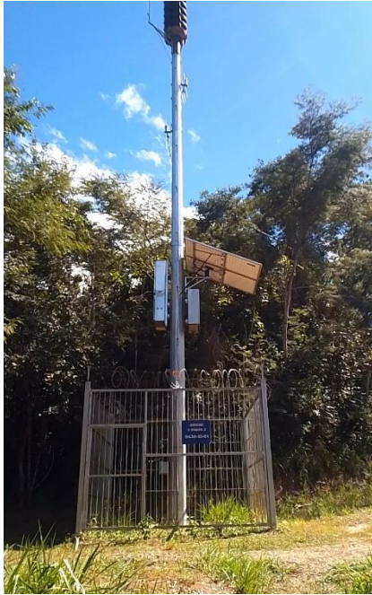
Visita de campo - Instalação da Sirene TW03 . Barragem de Rejeitos, Anglo American. Conceição do Mato Dentro (MG), Maio/2026
