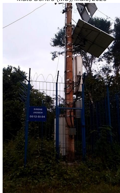
Visita de campo – Instalação da Sirene Jassém . Barragem de Rejeitos, Anglo American. Conceição do Mato Dentro (MG), Maio/2026
