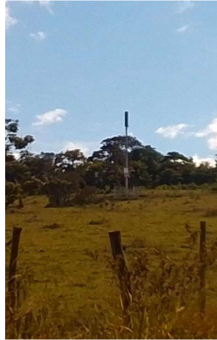
Visita de campo - Instalação da Sirene TW04 . Barragem de Rejeitos, Anglo American. Conceição do Mato Dentro (MG), Maio/2026
