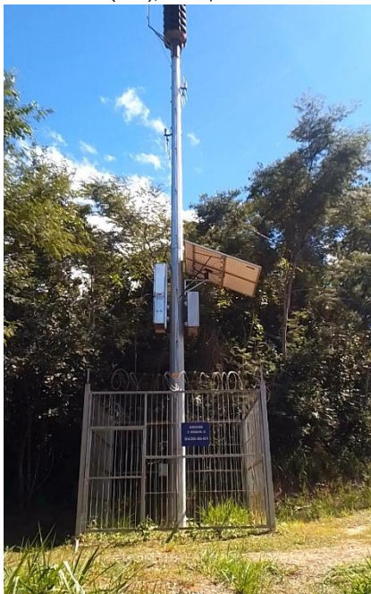
Visita de campo - Instalação da Sirene TW07 . Barragem de Rejeitos, Anglo American. Conceição do Mato Dentro (MG), Maio/2026
