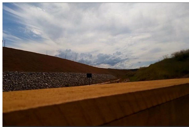
Visita de campo – Placa sinalizadora da Rota de Fuga RF-PE-03-BRJ-OD-A . Barragem de Rejeitos, Anglo American. Conceição do Mato Dentro (MG), Maio/2026
